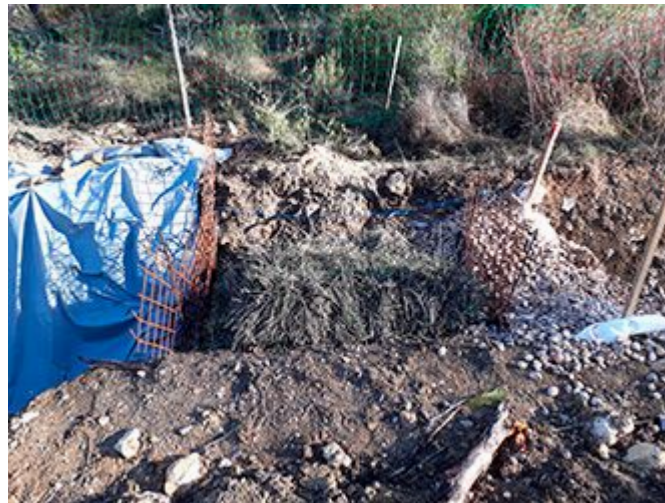
Filtre à paille et zone de décantation
