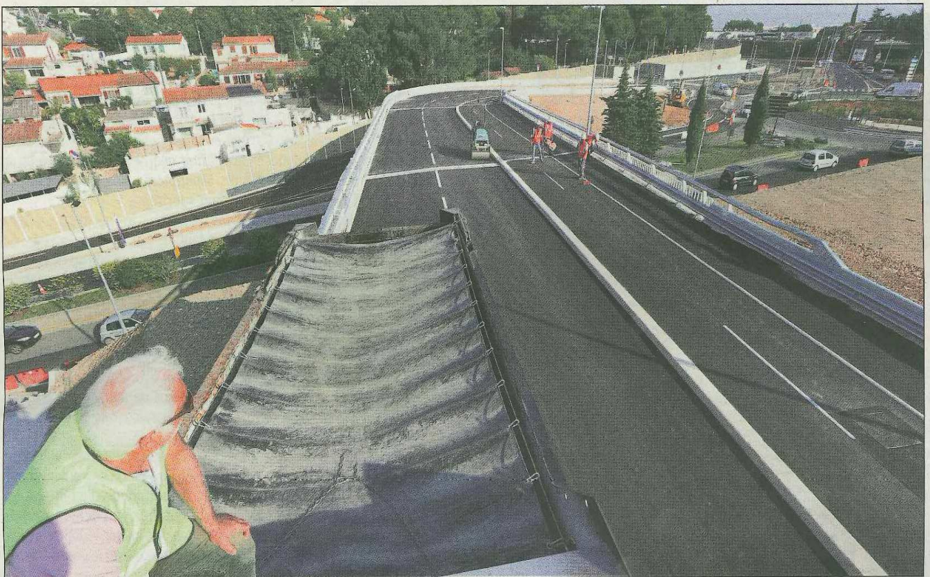
Le chantier du bus tram, contesté devant le Conseil d'État, est déjà bien avancé.
